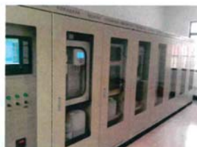
站房内部机柜组
