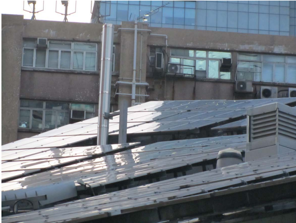
圖 50 零碳天地生物柴油發電設備
