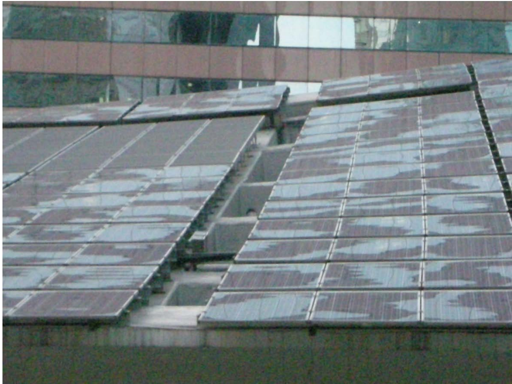
圖 49 零碳天地屋頂太陽能板
