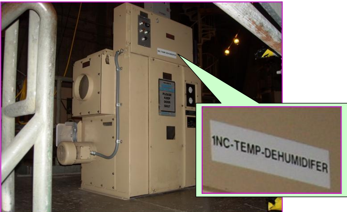
現場設備乾式保存使用的除濕機 (Dehumidifier)
