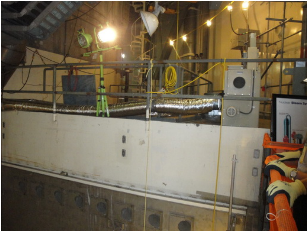
反應器廠房相關設備使用外接除濕機 (Dehumidifier) 乾式保存
