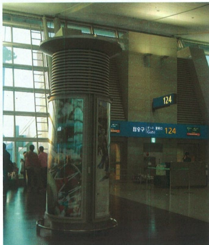
仁川機場內候機室的空調出風口
