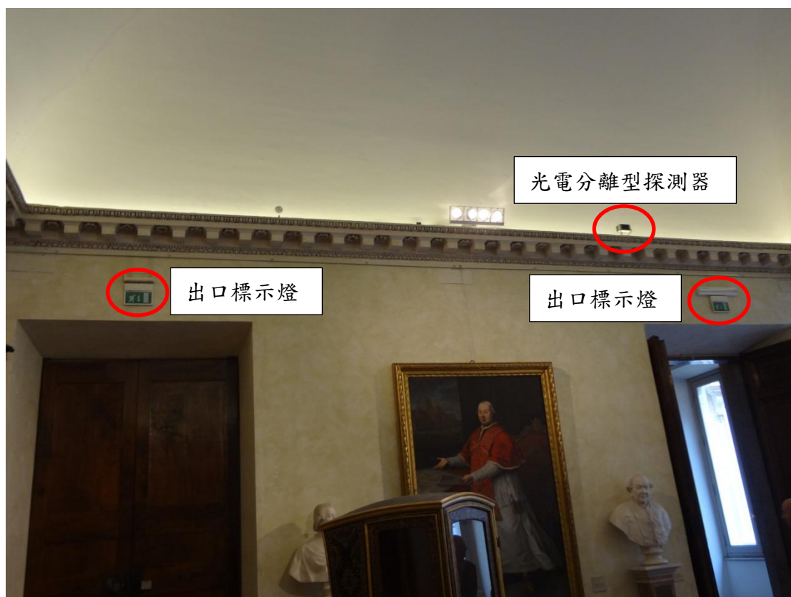
出口標示燈及火警探測器裝置情形
