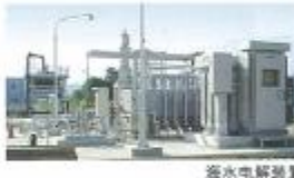
海水电脱装置
