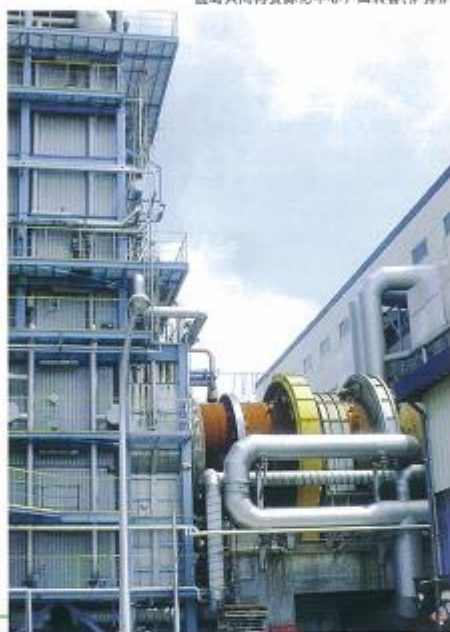
鹿岛共同再资源化中心 / 回转窑、炉排炉
