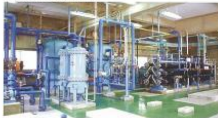
RO式海水淡化系统(南大东岛)
