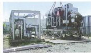
土壤净化系统 / 土壤加热炉
