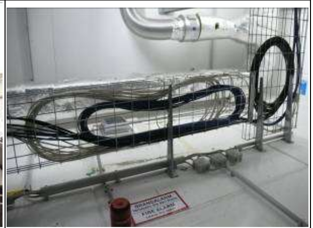
電腦控制室網路線設置
