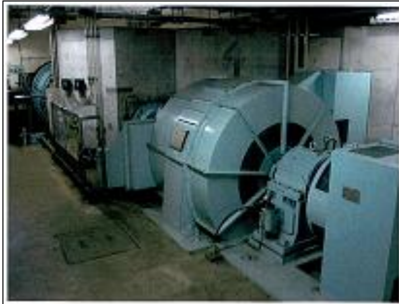
圖 65:東村山淨水場水力發電設備
