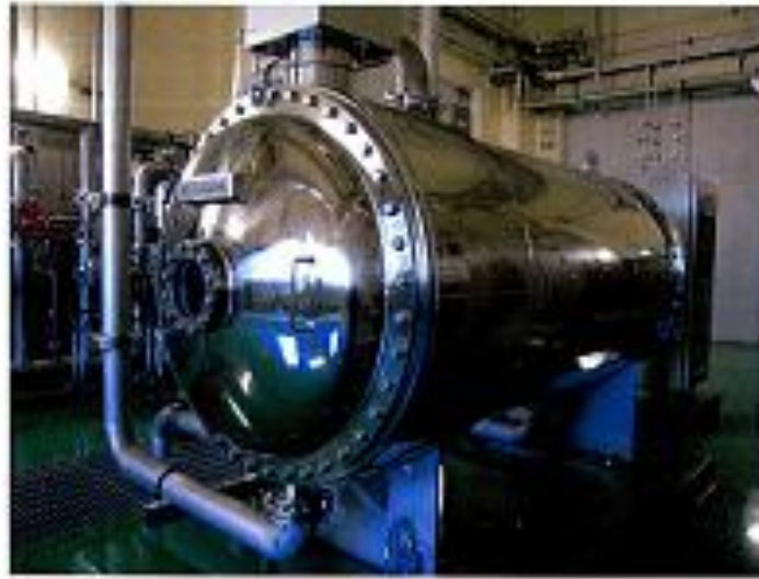
圖 62:東村山淨水場高濃度臭氧製造設備
