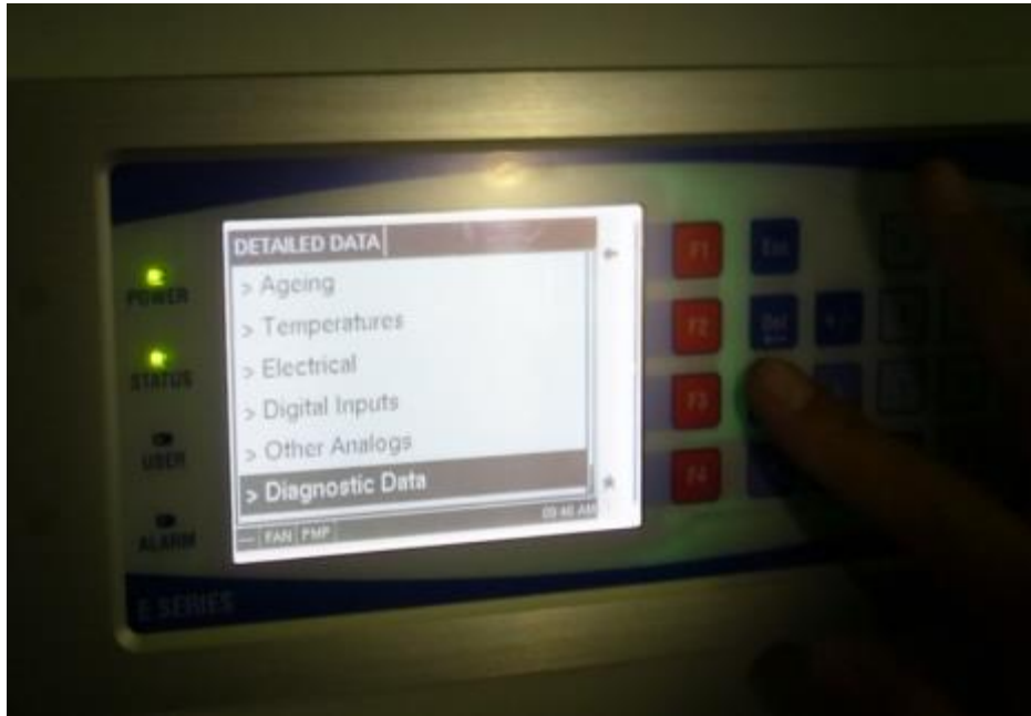
圖 參-45 應用智慧化線上監測/診斷與變電設備資產管理
