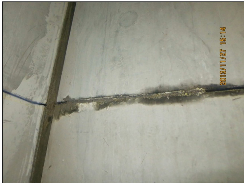
圖 19、逃生河道滲漏水狀況
