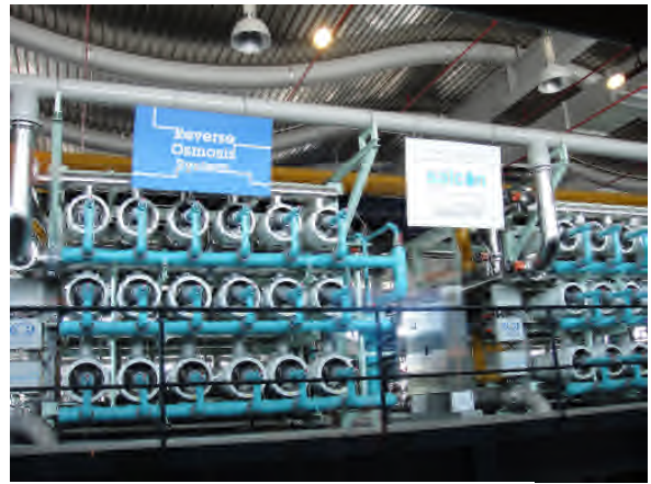
圖 2、Bedok 新生水廠 RO 系統
