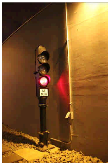
圖 5-4 地鐵警示燈號設施
