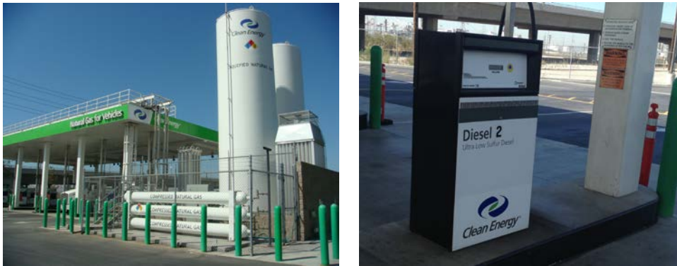
圖 4-18 LNG 加氣站及超低硫分油島
