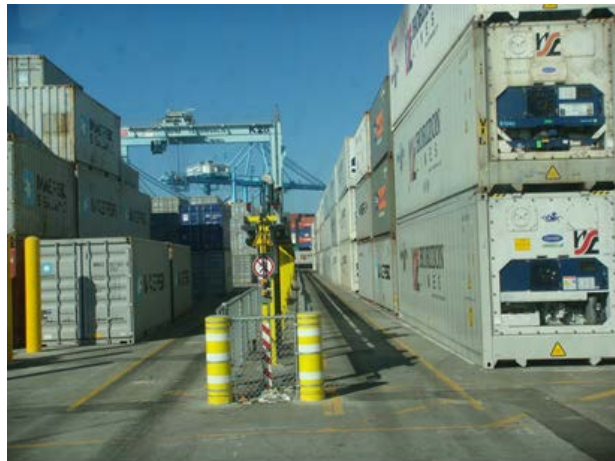
圖 4-12 冷凍貨櫃電力輸送線
