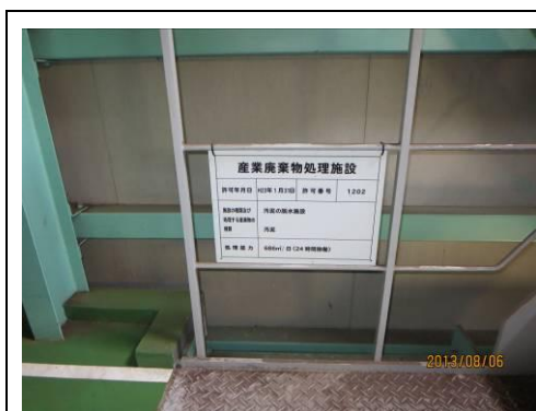
污泥處理設施
