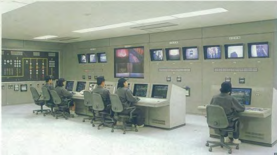
中央制御室 工場内のいろいろな機器の運転操作、管理、監視制御をここで集中して行ないます。
