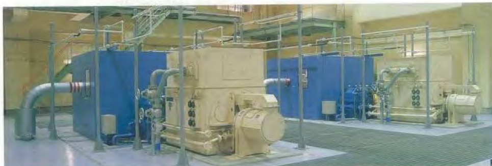
蒸気タービン発電機 ボイラで作られた蒸気で1基あたり最大4,500kWの発電を行います。発電電力は工場内と併設施設で利用され、余剰分は電力会社へ送電され家庭でも利用されます。
