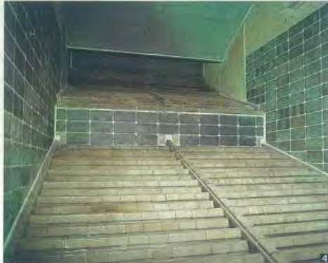
焼却炉 ごみは階段状の火格子で送られながら約800～950℃の高温で安定して焼却されます。
