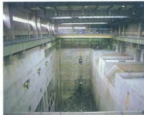
ごみビット・ごみクレーン ごみビットに一旦貯留されたごみは、ごみクレーンにより、良くかくはんされたあと焼却炉へ運ばれます。
