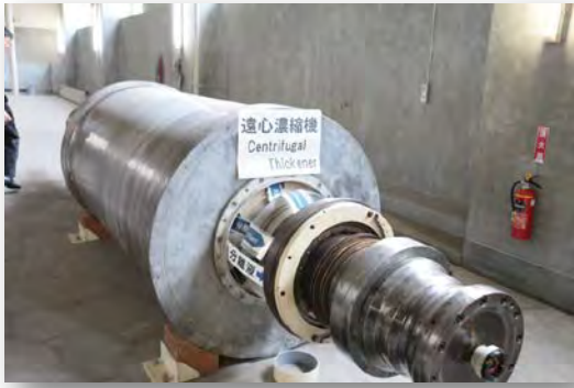
污泥濃縮設備
