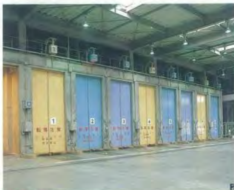
プラットフォーム 搬入されたごみはここで収集車からごみビットに投入されます。また、搬入車両の誘導、投入扉の行先指示も自動で行なわれます。
