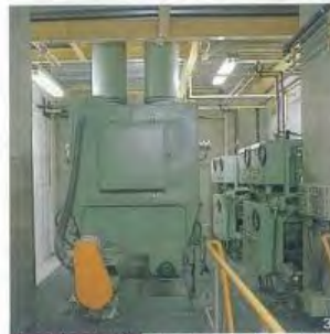
タスト処理装置 ろ過式集じん器で捕集された飛灰を薬剤添加処理します。
