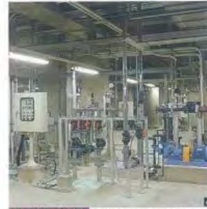
排水処理設備 工場内で発生するプラント排水は、排水処理設備で処理し、再利用されます。
