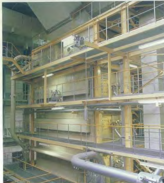
ボイラ ごみ焼却によって発生する燃焼ガスはボイラによって冷却され、そのエネルギーは蒸気として回収されます。
