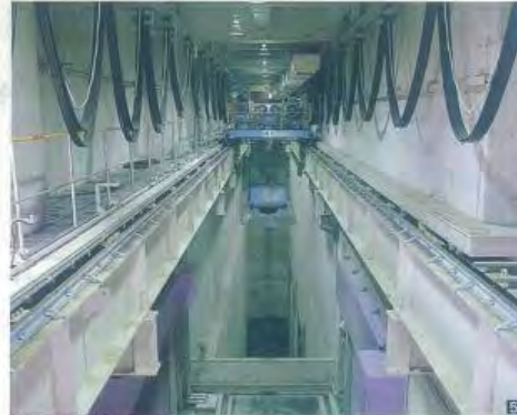
灰ビッド・灰クレーン 焼却灰は冷却されたあと、灰ビッドに運ばれ、灰クレーンにより搬出車に積み込まれ、埋立地へ運ばれます。
