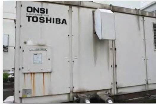
燃料電池發電設備
