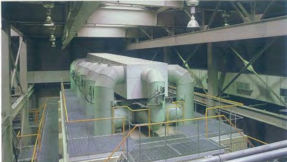
ろ過式集じん器 排ガス中のばいじんや塩化水素などを除去します。
