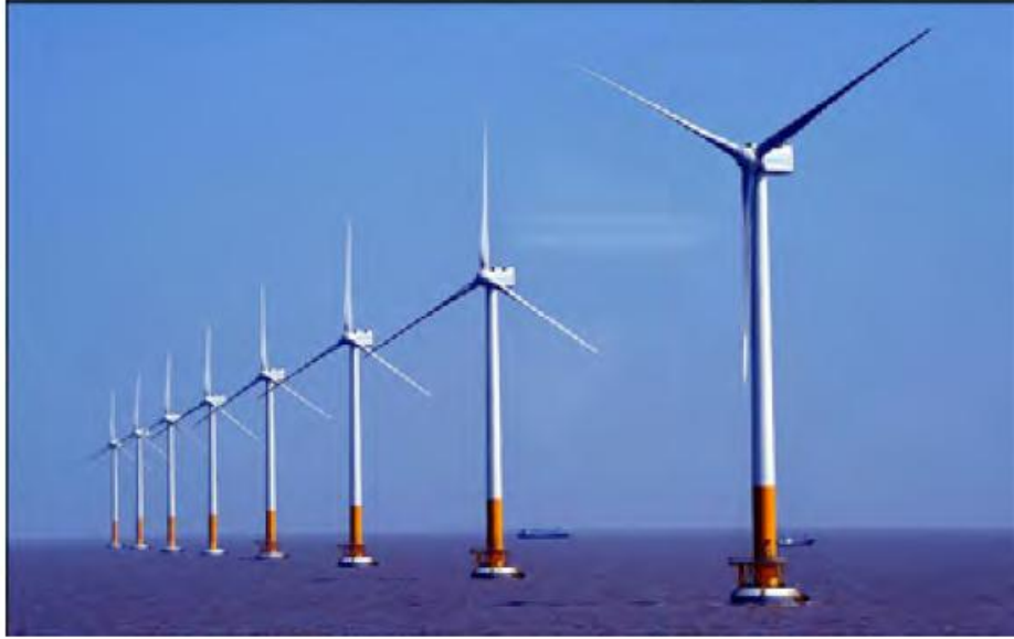
圖 3.26 Shanghai Donghai-Bridge wind farm
