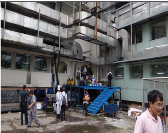
圖-戶外排風管線相關設備細部照片
