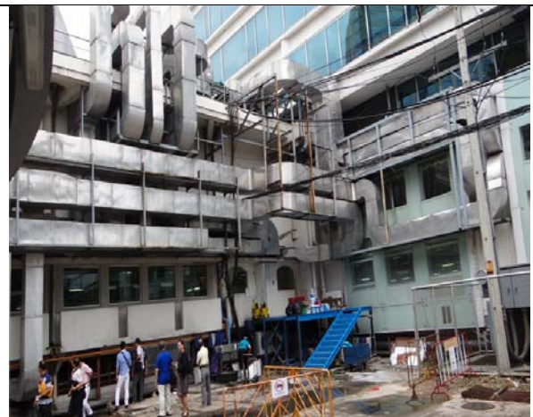
圖-戶外排風管線相關設備細部照片
