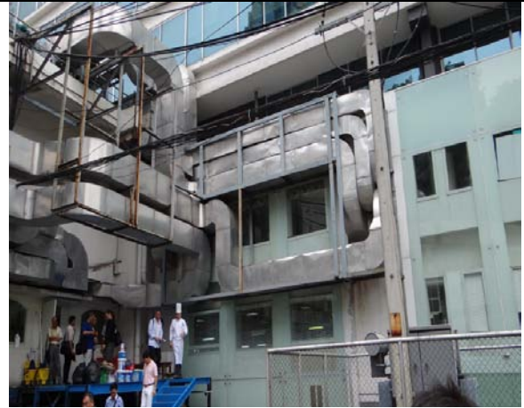
圖-戶外排風管線相關設備細部照片
