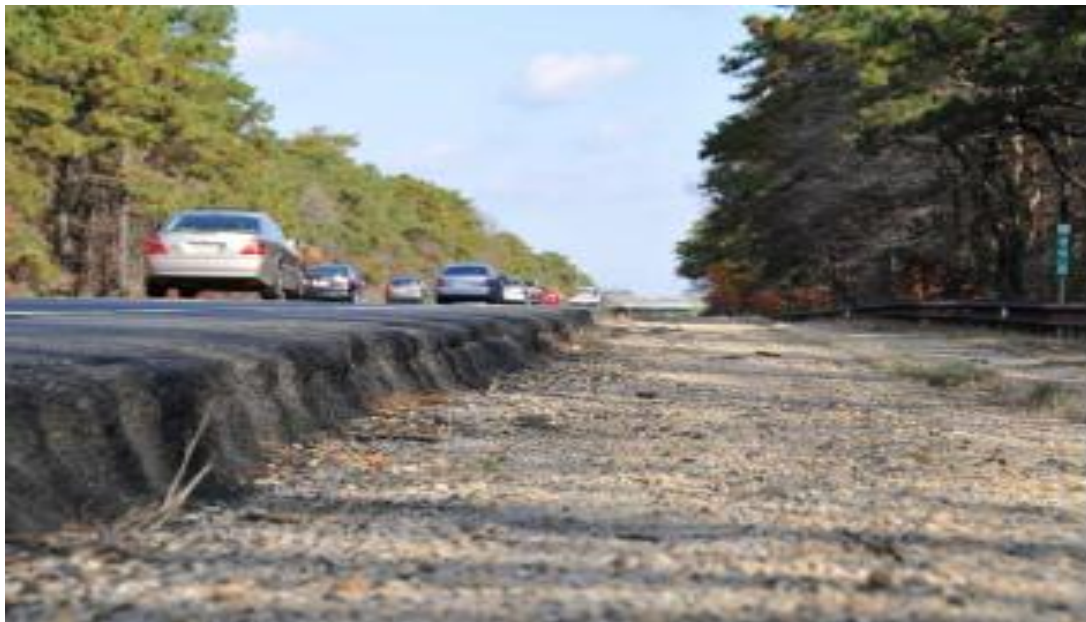
圖 36.路肩陡峭狀況
