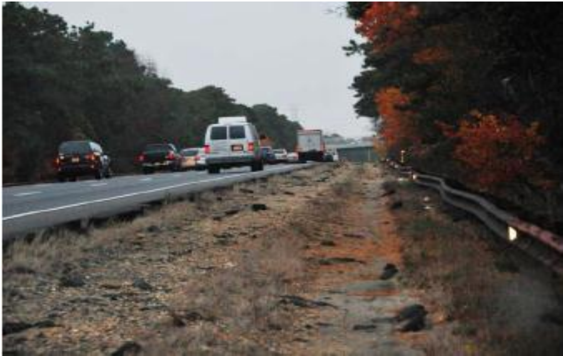
圖 37.路肩陡峭狀況
