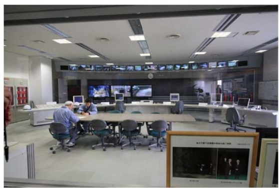
照片 3-09 說明：管理單位～儀控中心
