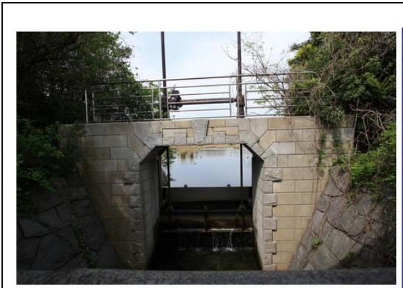
照片 5-14 說明：上、下池水位控制閘門
