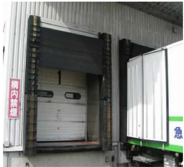
完備的門封(dock shelter)確保溫層穩定
