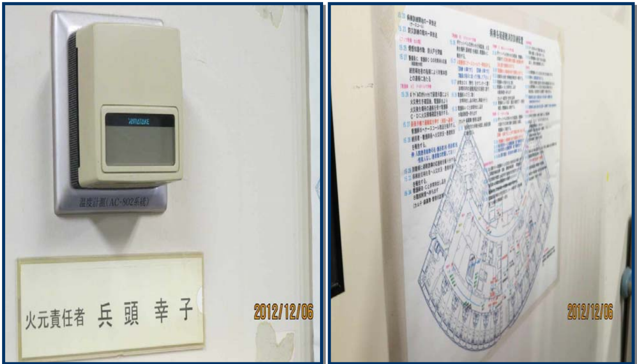
照片 8-4、住友病院病房相關消防通報、負責人及相關設施設置情形
