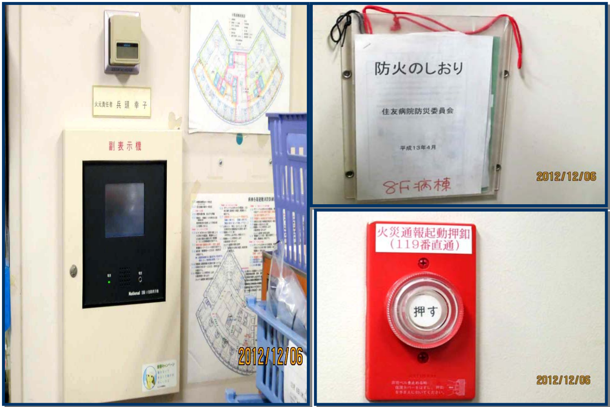
照片 8-3、住友病院病房相關消防逃生路線、警報器及相關設施、標誌等設置情形
