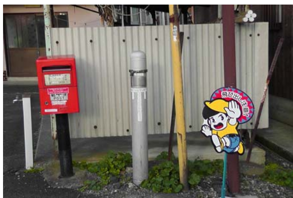
圖 3-47 下水道換氣管
