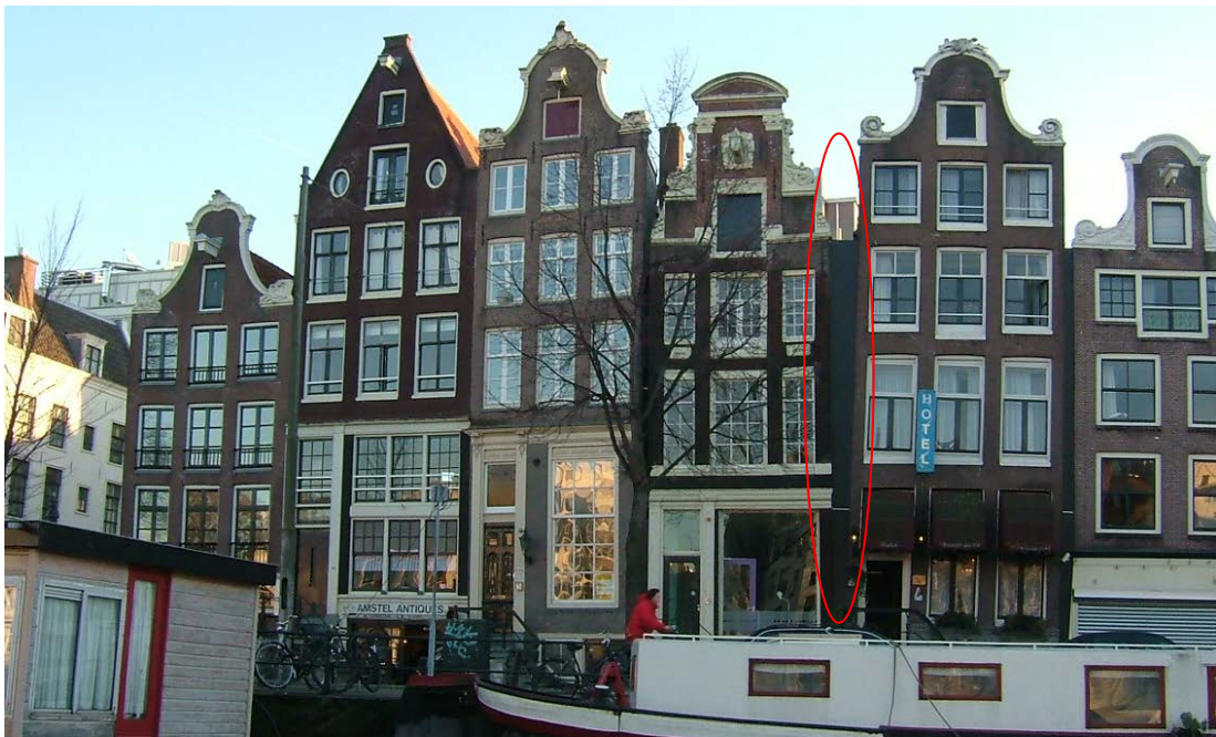
圖 24 地層差異沉陷對建築物造成威脅
