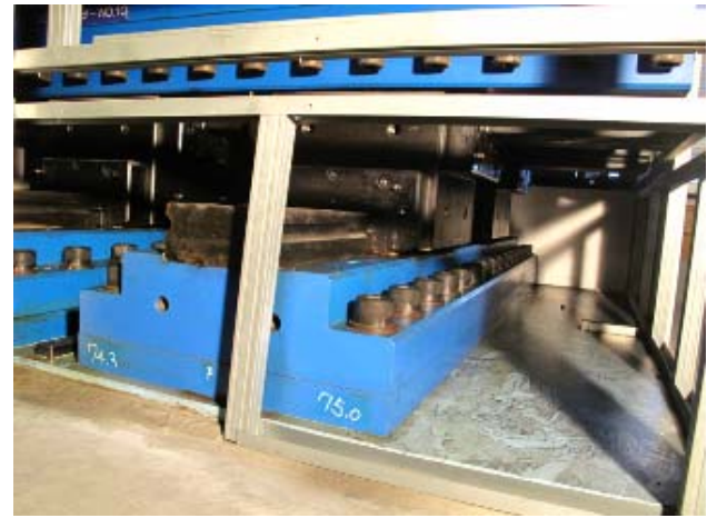
圖八 鑽石塔大樓之滑軌隔震系統
