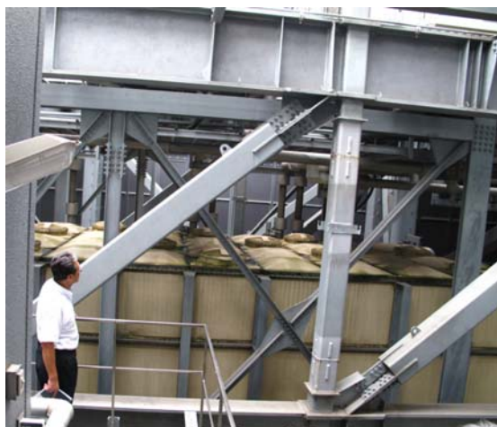
圖九 鑽石塔大樓之單擺式 TMD
