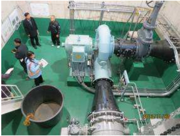
法蘭西式水車發電設備
