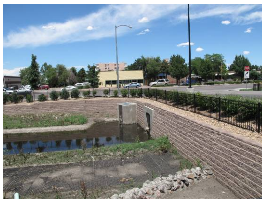
商業區末端貯洪池(二)右側進水口
