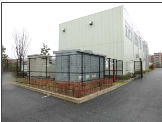
緊急發電設施 資料來源：市川市役所網頁
