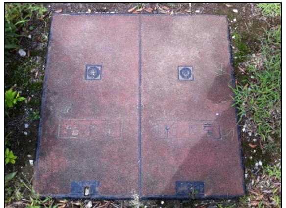
飲用水貯水槽管接水處
