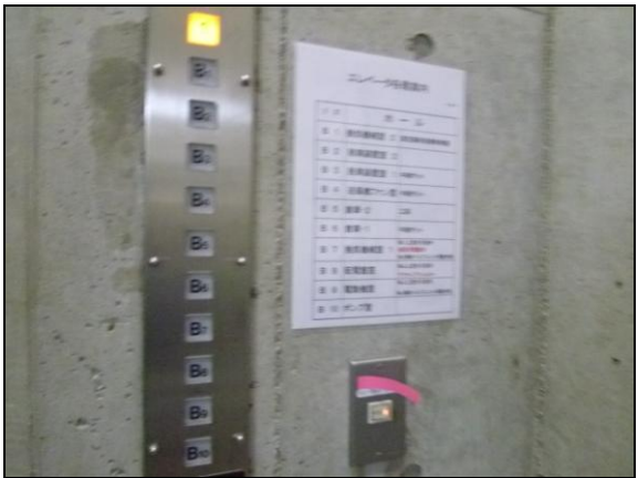
地下 10 樓的電梯
