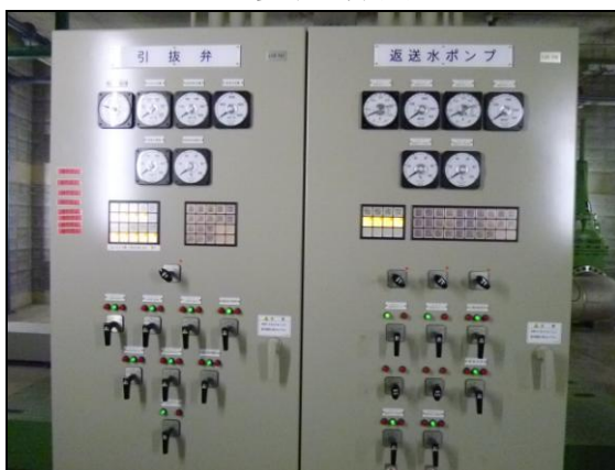
抽排水監測裝置
