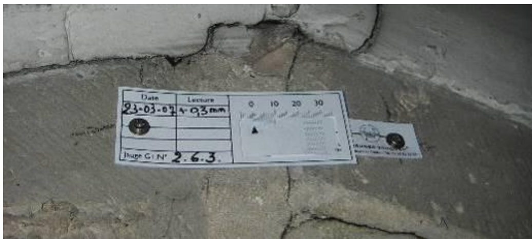
Monumentenwacht Vlaanderen 監測建築裂縫所用量尺。固定於壁體上後，可由管理人員定期檢視裂縫有無持續裂開並進行記錄。如圖內自固定後，再次檢視，發現增加 0.3mm 裂縫。(Monumentenwacht 提供)
