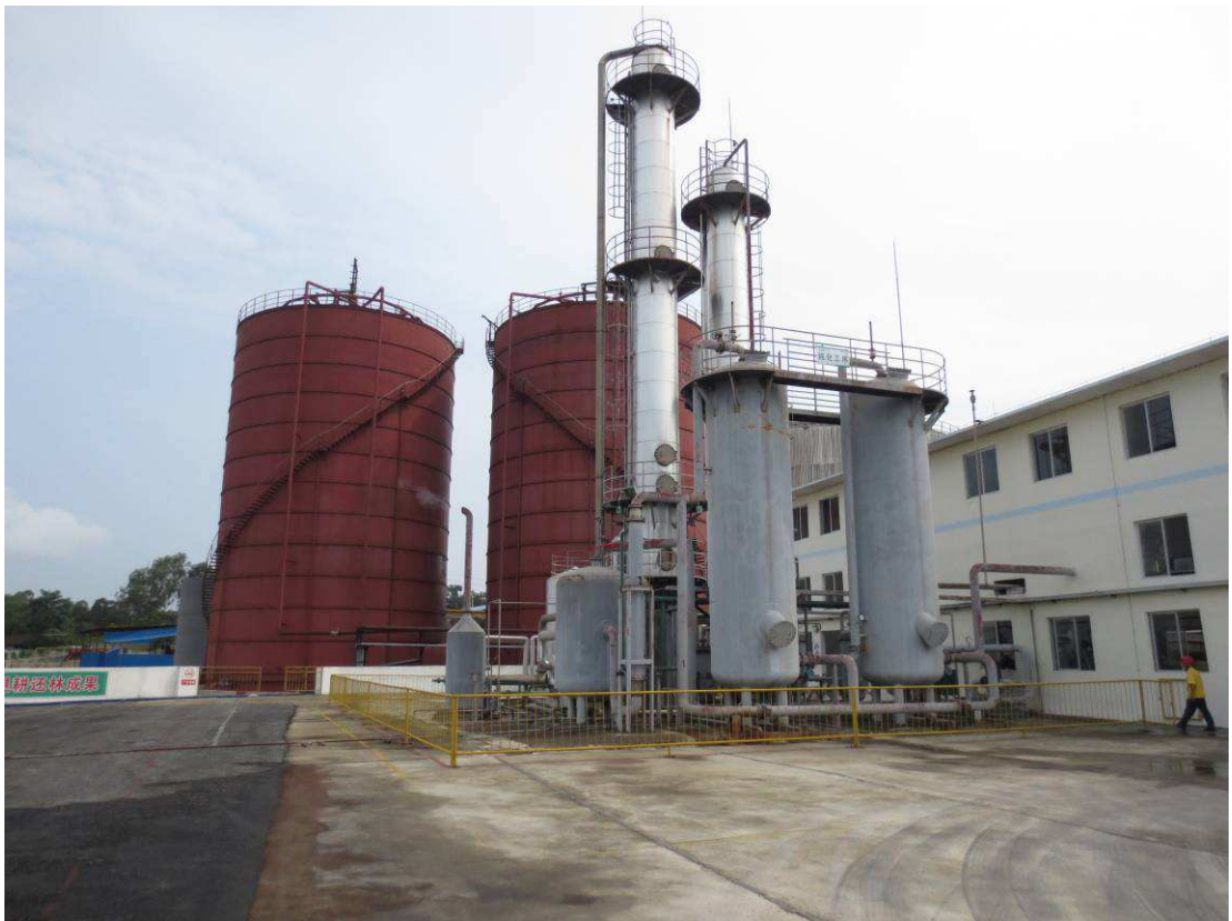
圖 8 澱粉沼氣廠脫硫設施及厭氧槽
