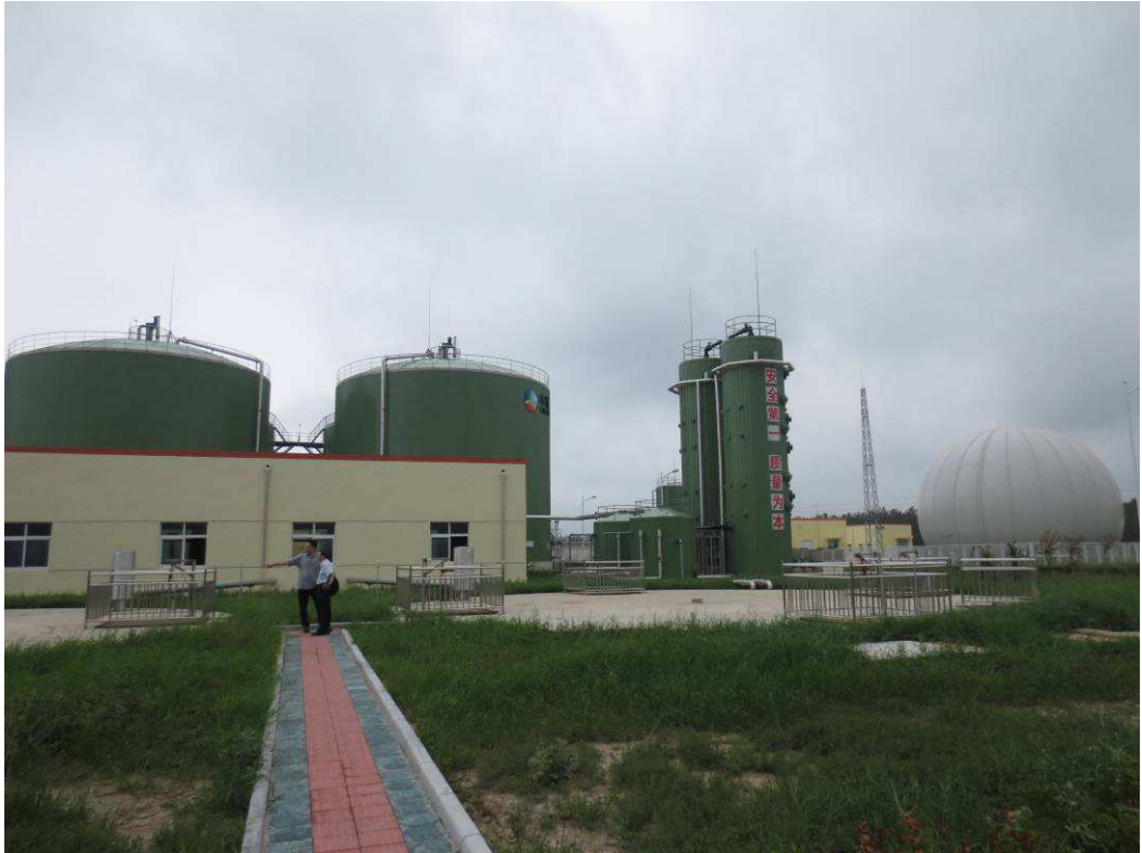
圖 13 調節池、厭氧醱酵槽、生物脫硫塔及儲氣槽
