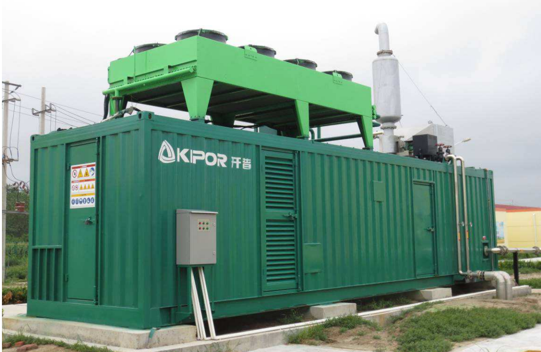
圖 20 開普牌發電機 (內部為 LG Janbacher gas engines)
