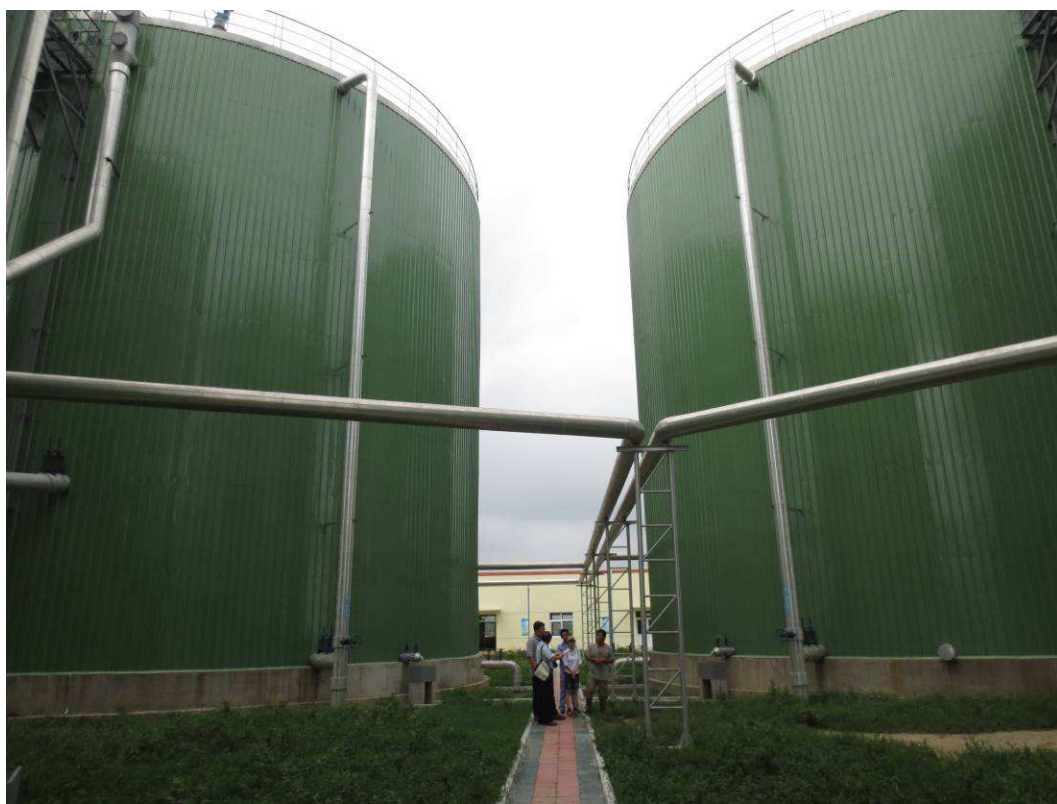
圖 16 厭氧醱酵槽間管線
