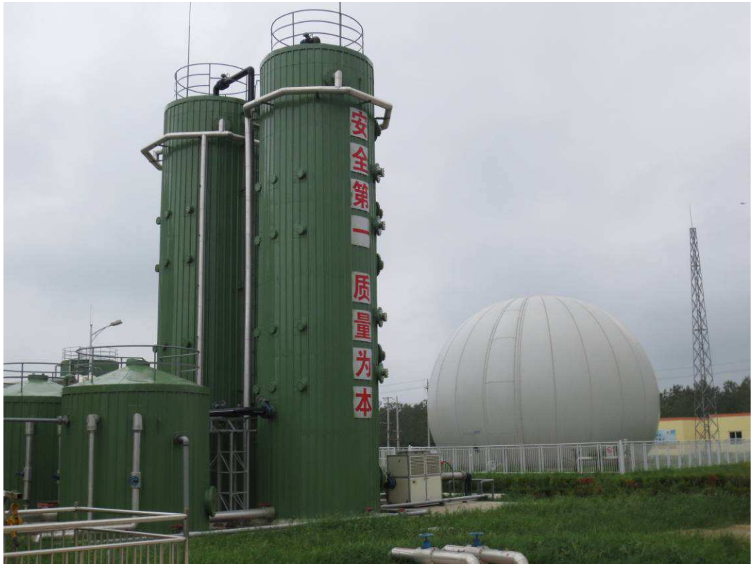
圖 17 生物脫硫塔及儲氣槽
