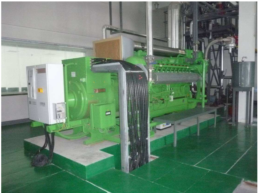
圖 28 發電機組設施
