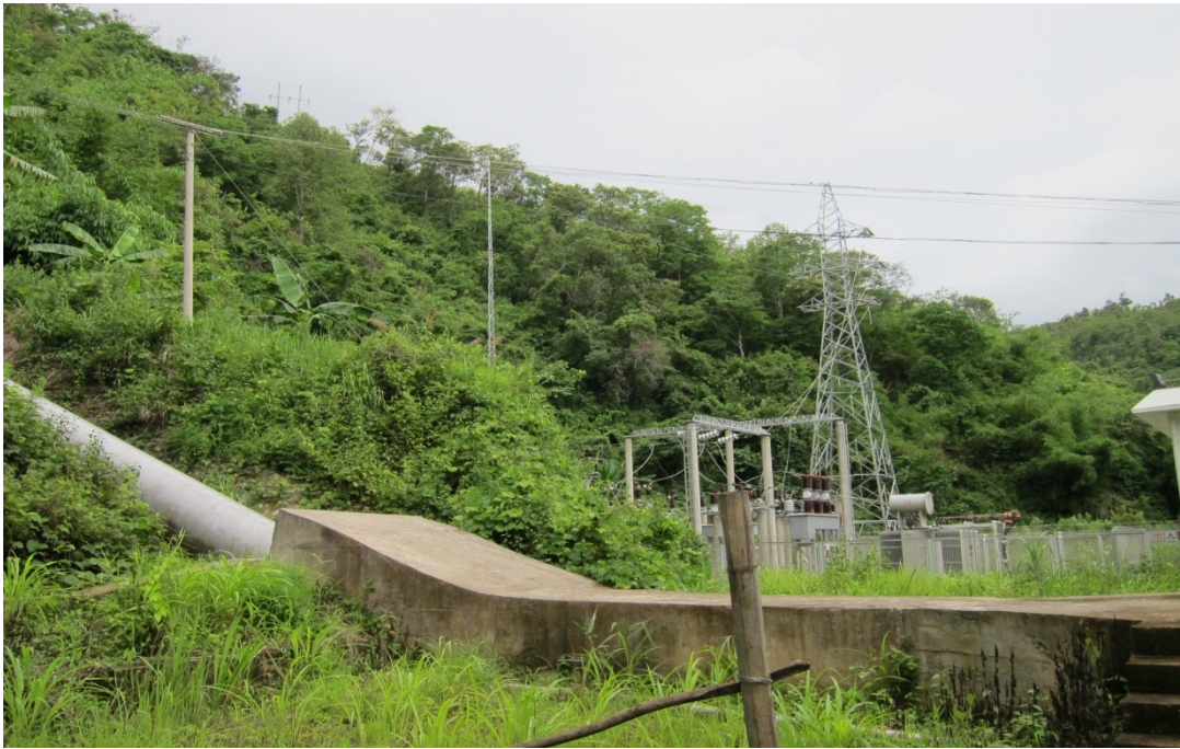
圖 6 偏遠山區水電站之輸變電設施
