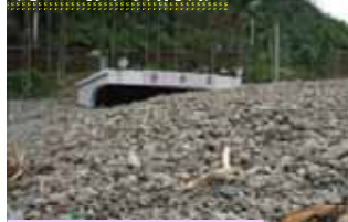
原址損壞情形
