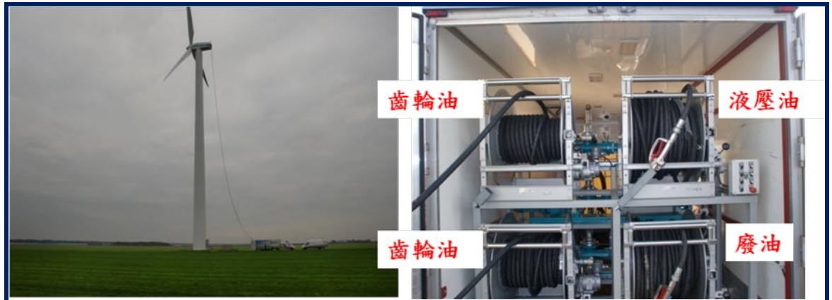
圖 3-19 油品更換設備
