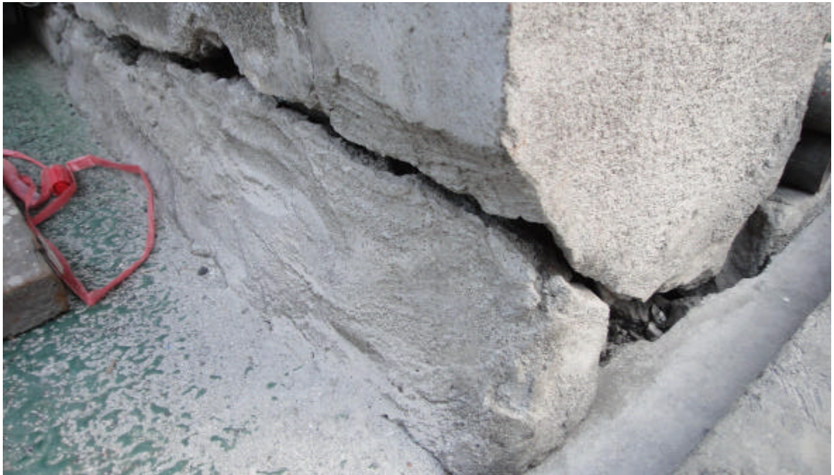
外牆嚴重龜裂
