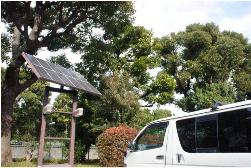
丸之内公園停車場設置太陽能板供照明設施使用
