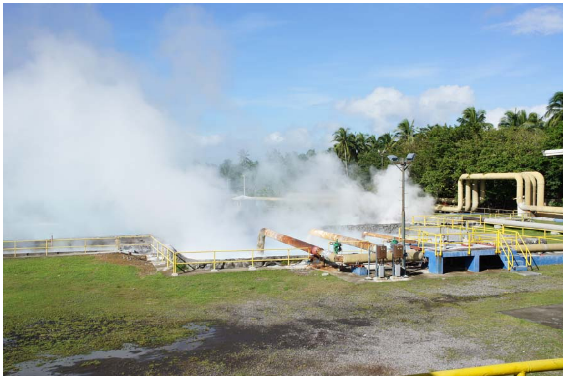
圖 3：Mak-Ban 地熱電廠地熱回注井之熱水停滯池
