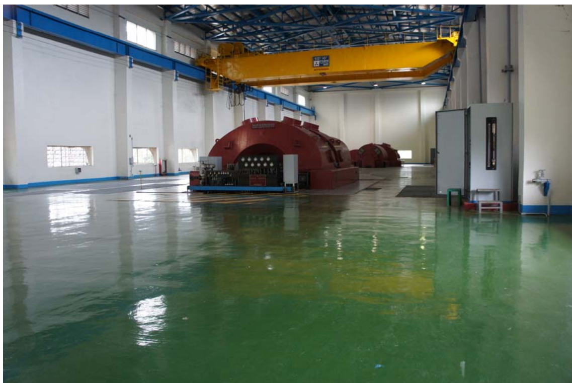
圖 4：Mak-Ban 地熱電廠渦輪發電機
