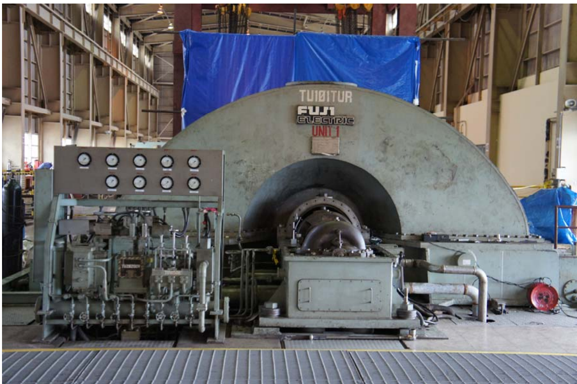
圖 10：Palinpinon 地熱電廠渦輪發電機
