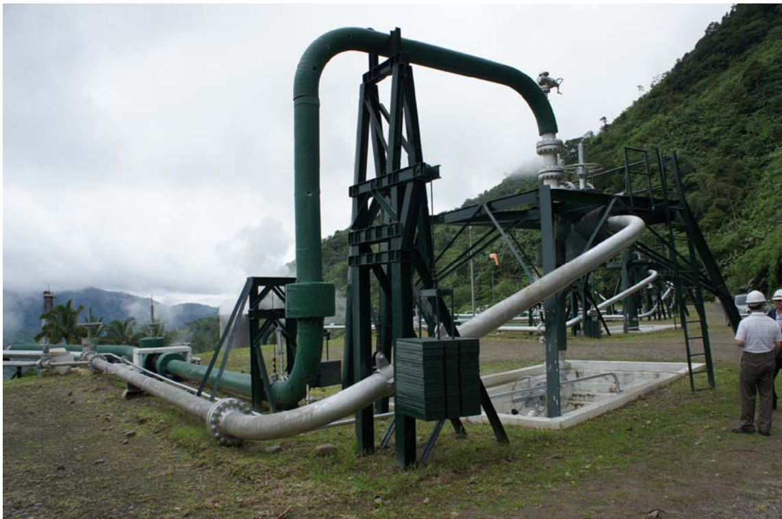
圖 8：Palinpinon 地熱電廠地熱生產井
