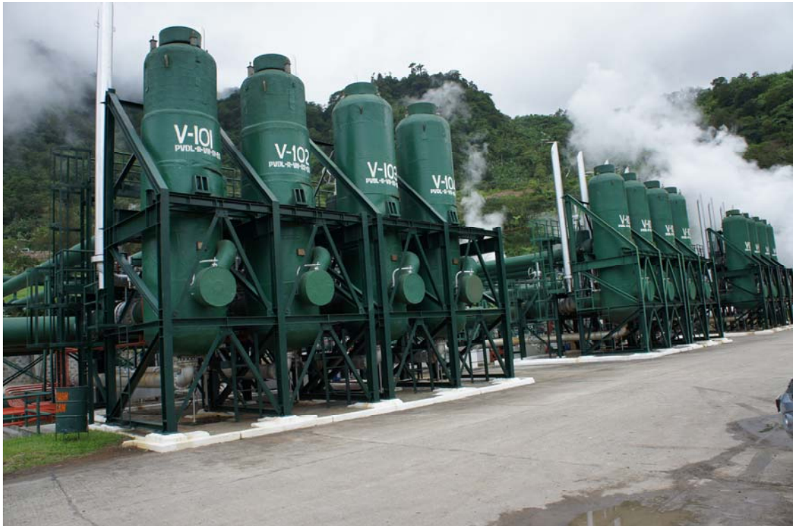
圖 9：Palinpinon 地熱電廠地熱汽/水分離設備
