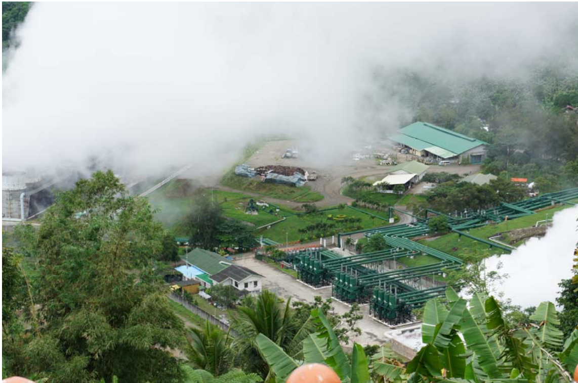
圖 7：Palinpinon 地熱電廠地熱汽/水分離區遠覽
