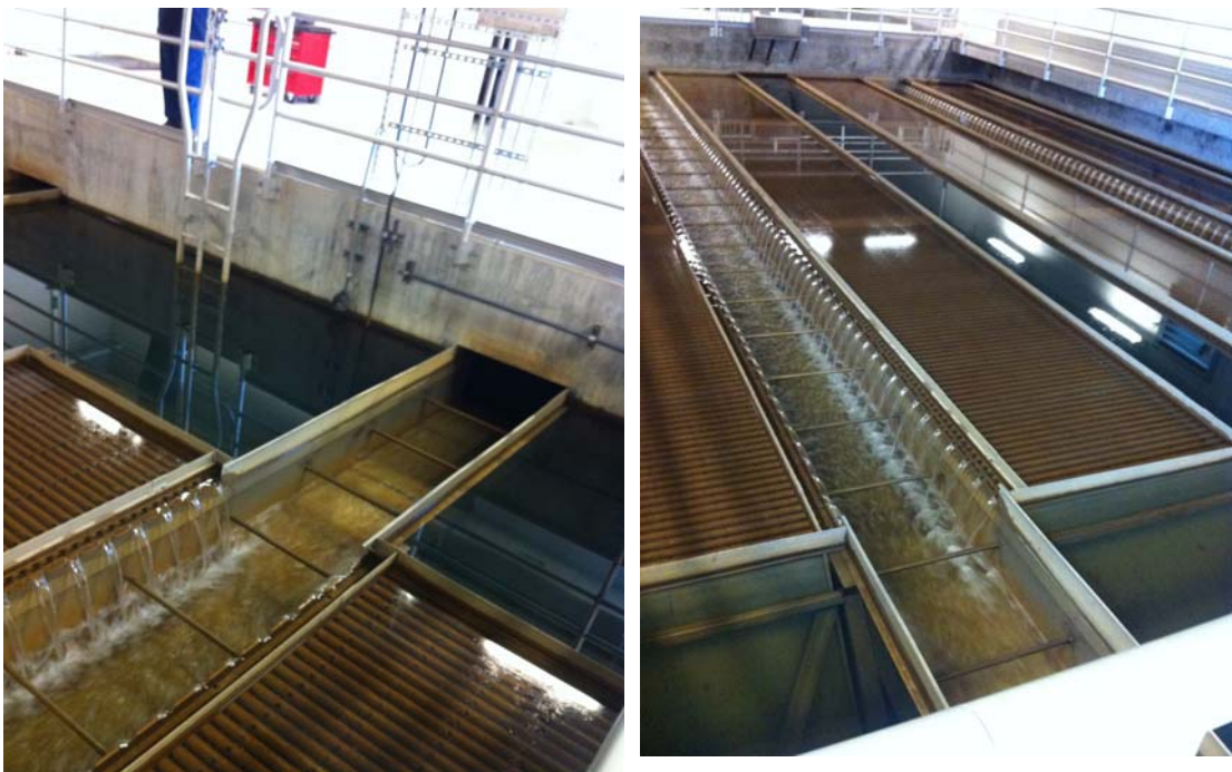
圖 12. Lynn R. Morgan Water Treatment Plant 傳統處理單元
