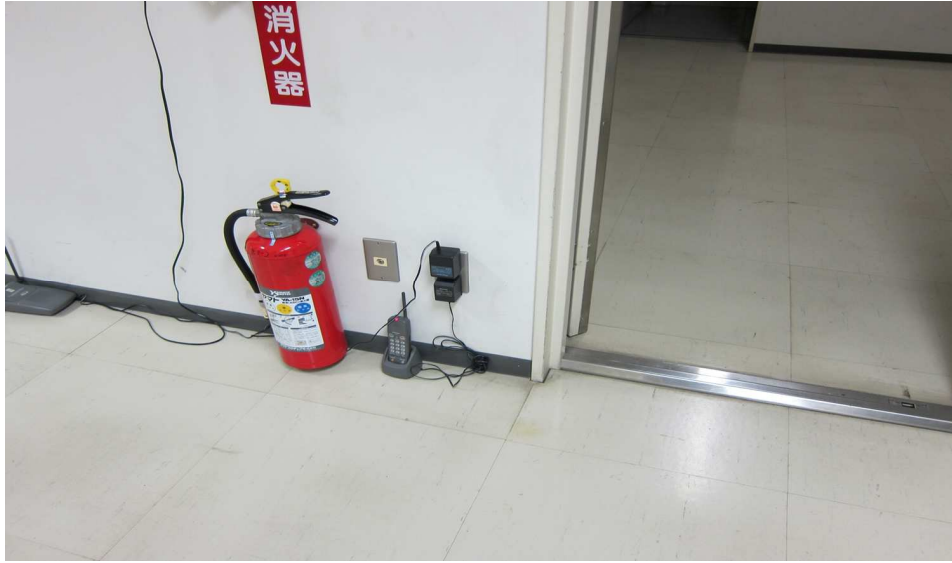
圖 23 控制室入口處設置無線通訊設備
