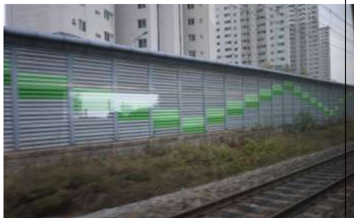
照片59：KTX(韓國高鐵)隔音牆多為3公尺高 (頂緣吸音筒型)
