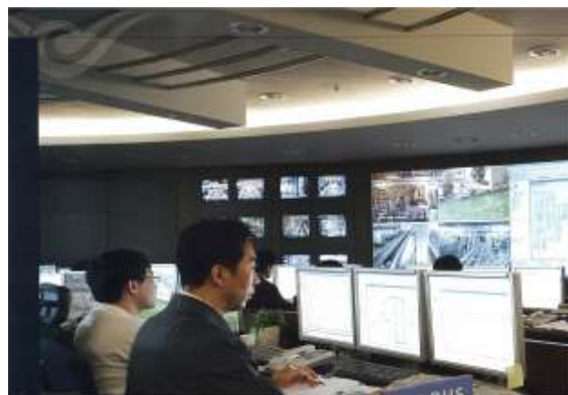
照片26：仁川機場行李處理區之中央控制室
