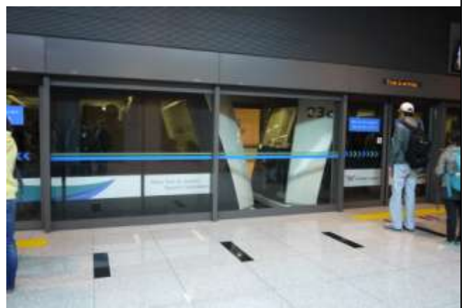
照片12：仁川機場鐵路地下車站月台門
