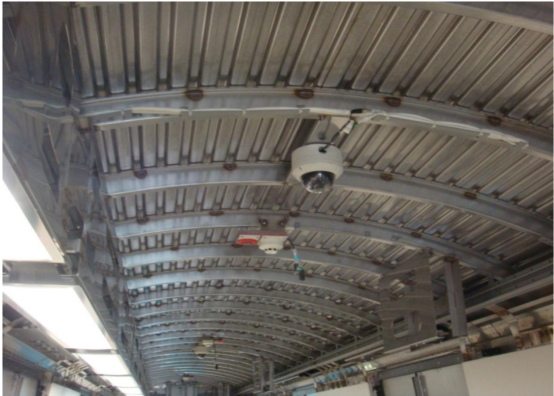
圖 9. 車頂 CCTV 攝影機及煙霧偵測器
