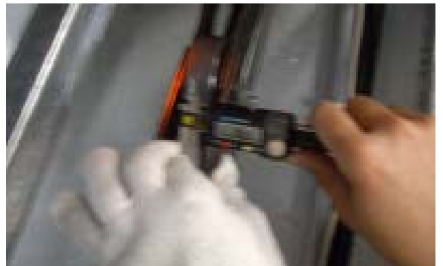
圖 36 踏板鏈條檢測(13KV-C)
