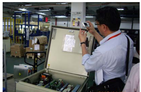
圖 47 工廠參觀-控制箱品管檢驗區
