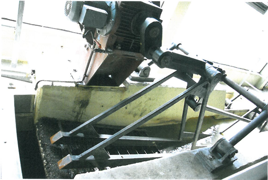
圖 29、砂及隔油池的除砂機
