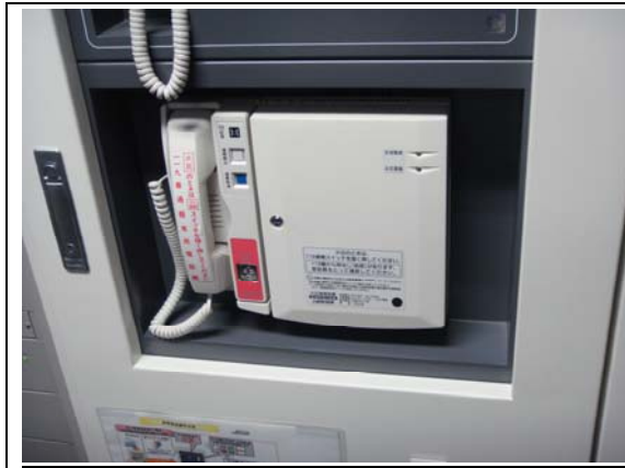
八重洲龍名館內設置之 119 火災通報裝置
