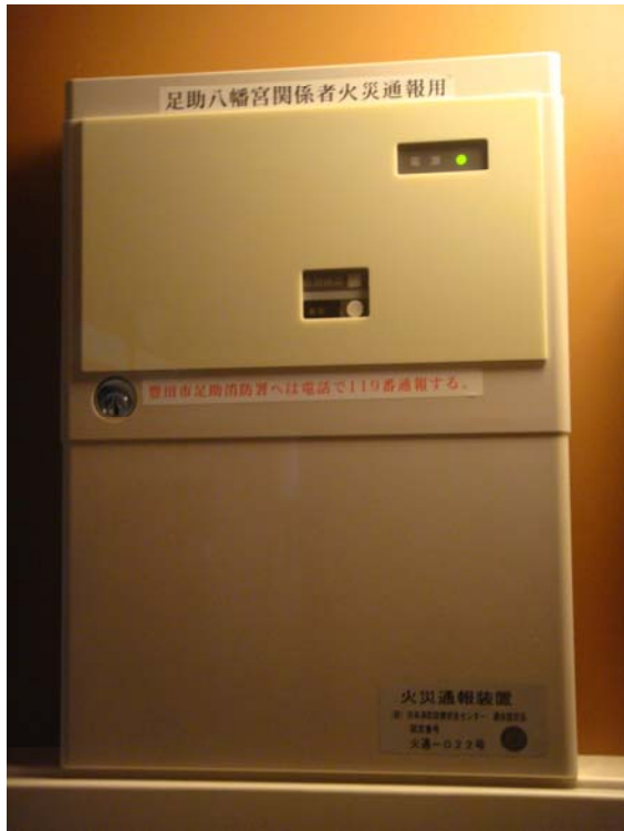
足助八幡宮設置之119火災通報裝置
