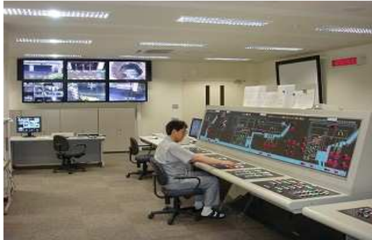
神田川・環状七号線管理中心 地下調節池
