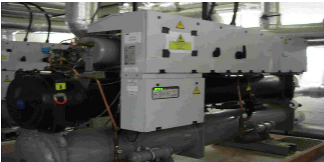
圖 3.82 大樓空調主機
