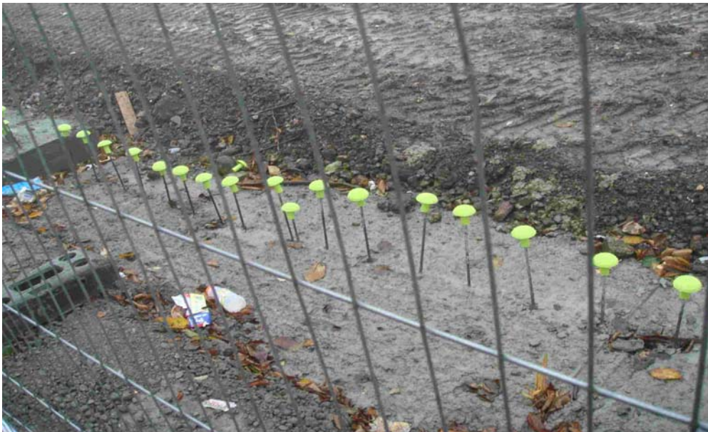
圖 3.61 凸出路面鋼筋防護
