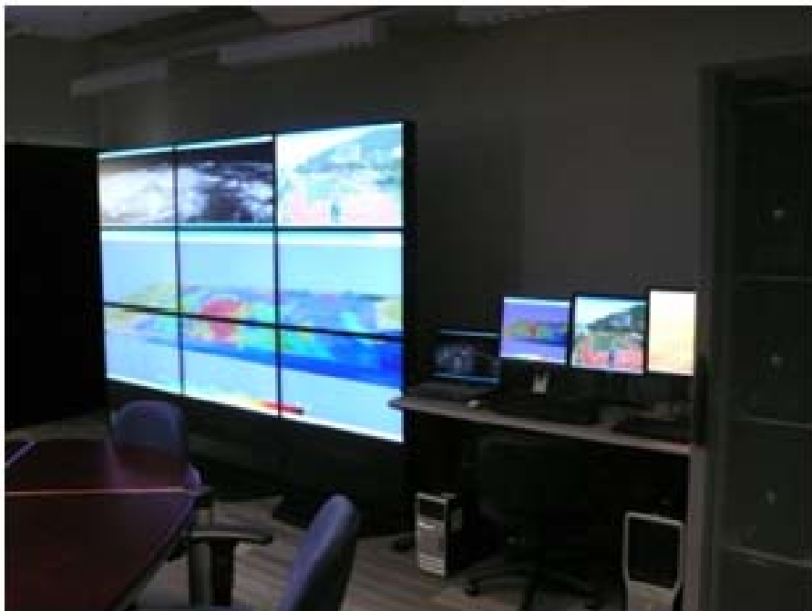
圖 3-6 衛星遙感地面接收站即時監控設備
