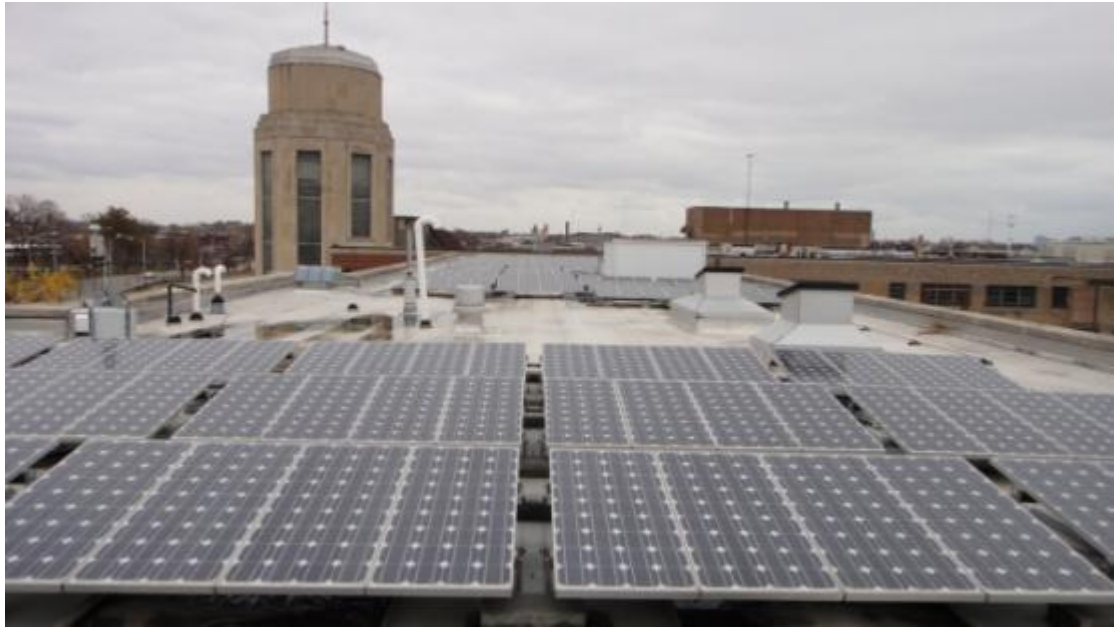
屋頂設置太陽能光電板發電
