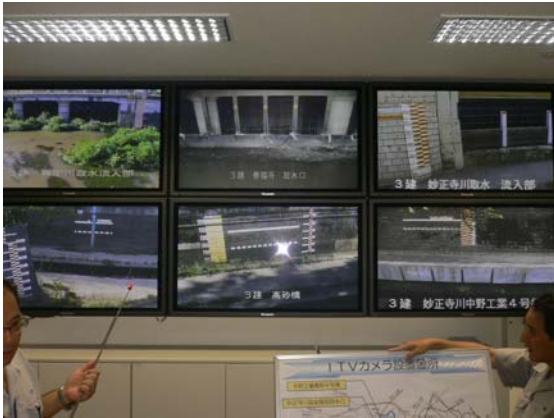
圖 24 調節池管理監控中心
