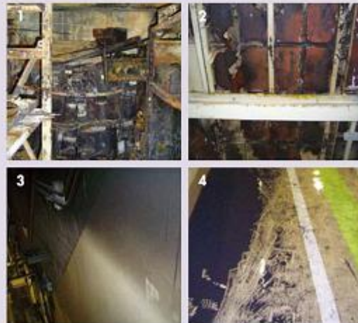
1・2: 出火場所(廃棄物処理建屋内) 3: 火災による煙層の跡が残っている 4: すすが堆積した廊下 1・2: Where fire started (inside a waste material processing building) 3: The wall shows smoke layer 4: Corridor covered in soot
