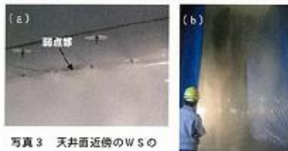
写真3 天井面近傍のWSの弱点部(a)及び高さ5mでのWSの状況(b)
