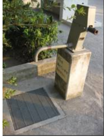
圖 79 堀切二丁目防災公園—雨水儲 槽出水口
