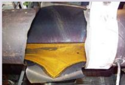
2004年 福井県にある原子力発電所で発生した二次冷却水配管の破断事故 2004 accident caused by the rupture of a secondary cooling pipe at a nuclear power plant in Fukui Prefecture
