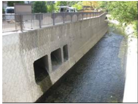
圖 33 妙正寺川第二調節池溢水孔
