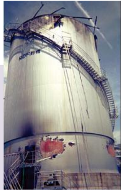
2003年 三重県のごみ固形化燃料(RDF)発電所で発生したRDF貯蔵槽の爆発事故 2003 explosion of an RDF storage silo at a refuse-derived fuel (RDF) power plant in Mie Prefecture
