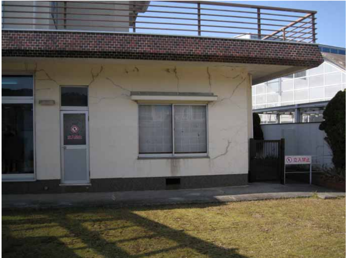
圖 84、北淡震災紀念公園 損壞建築
