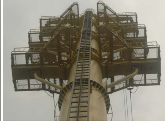
供人員上下動力升降設備
